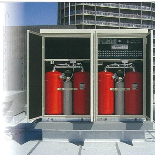
スプリネックス屋上設置例
